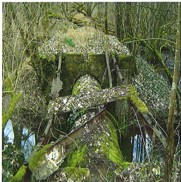
Traversée de Gare le Col (siphon)
